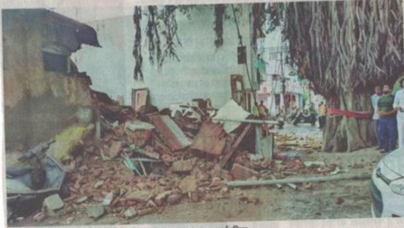
थावरिया बाजार में जर्जर मकान गिरने से मलबा सड़क तक आ गया। • नईदुनिया
