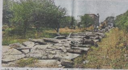
कनेरी रोड पर सर्वे नंबर 863/1 पर बनी अवैध कॉलोनी की सड़क उखाड़ी गई।
