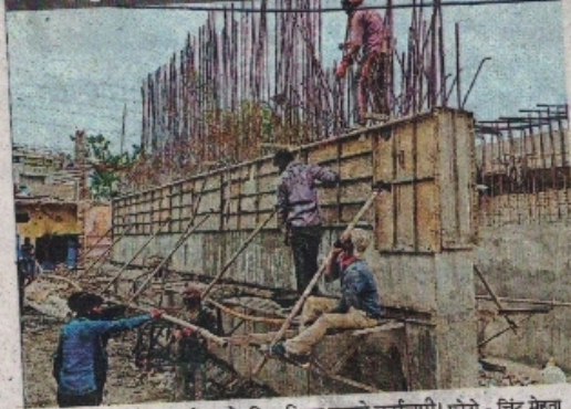
सुभाष नगर फ्लाई ओवर के लिए पिलर बनाते कर्मचारी। फोटो - चिटू मेहता
