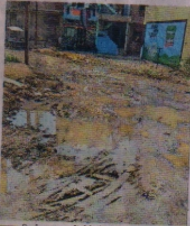
सड़क निर्माण शुरू नहीं होने से कर्मचारी कॉलोनी की मुख्य सड़क पर हो रहा कीचड़।
