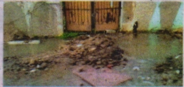
लोकेंद्र भवन मार्ग पर क्षतिग्रस्त पाइप लाइन से बहता पानी। • नईदुनिया
