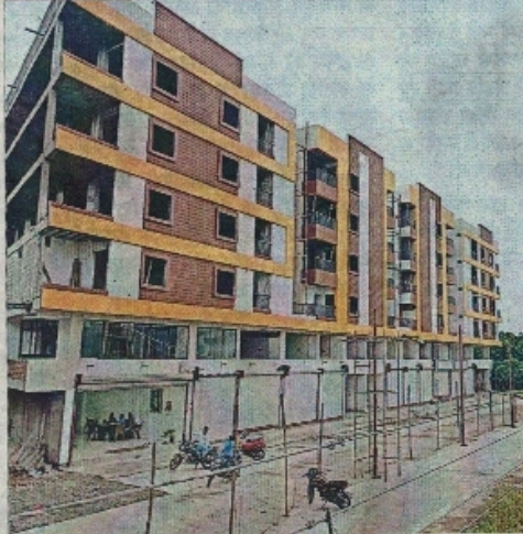
राम मंदिर के सामने निर्माणाधीन द्वारका रेजीडेंसी और उसके सामने की जमीन पर प्रशासन द्वारा लगाई गई लोहे की जाली।
